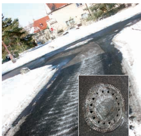
Sůl rozežtrá i kovové části silnic.
