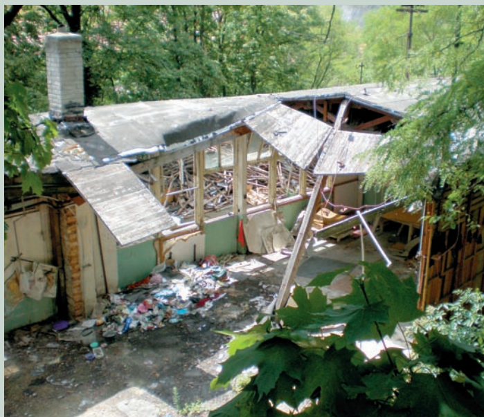
Jeden z objektů byl již v dezolátním stavu.
