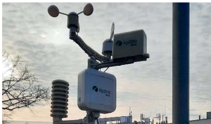
Meteostanice jsou umístěny na střeších školních budov. Foto: Pincity
