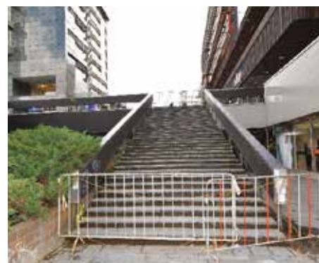
Stav schodiště z pasáže na terasu neodpovídal požadavkům na bezpečnost.
