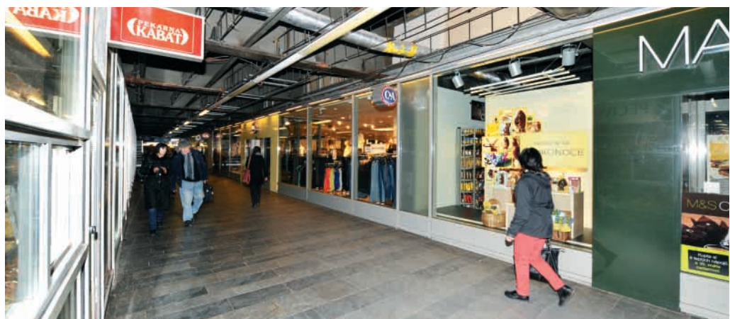
ZE ZASTŘEŠENÍ PODCHODU odpadávají kovové části podhledů a obklady.
